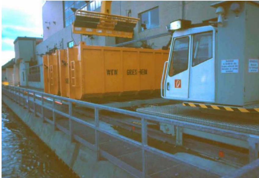
Abb. 3.25 Beispiel für die Geschwemmselentsorgung mit Direktabwurf am Wasserkraftwerk Griesheim am Main (Quelle: Muhr GmbH).
