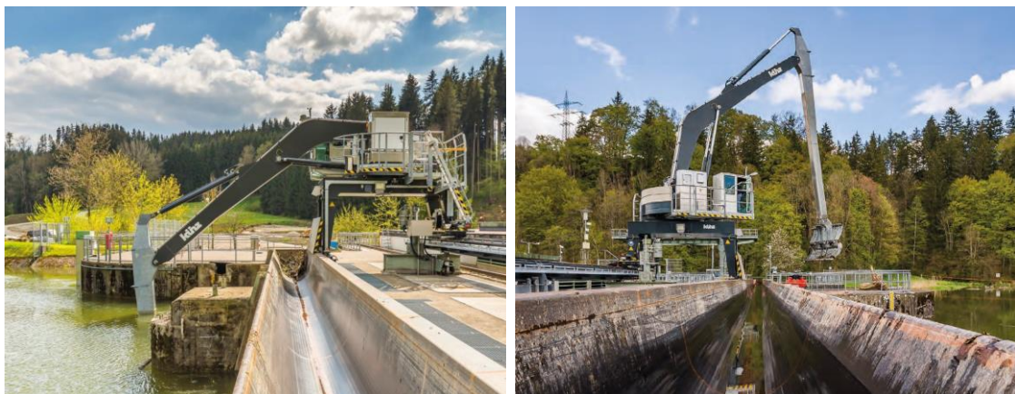
Abb. 3.27 Beispiel für die Geschwemmselentsorgung mit Stahlrinne am Wasserkraftwerk Altusried an der Iller (Quelle: Künz GmbH).
